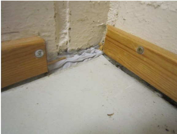
Kuva 4. Massatiivistyksiä. Korjaus ei vaikuta tiiviiltä.
